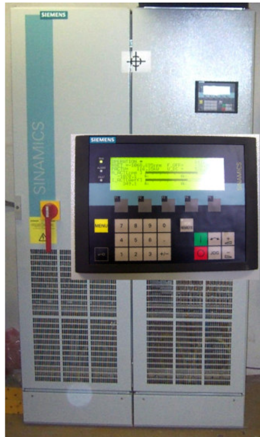
Slika 9: frekvenčni pretvornik za motor ventilatorja dimnih plinov
